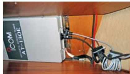
Observera de hoprullade kablar runt ferriterna som skyddar för HF mellan radio och tuner.
