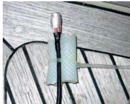
Antennanslutning + slangstumpar i vinterförvarat skeick till höger..
